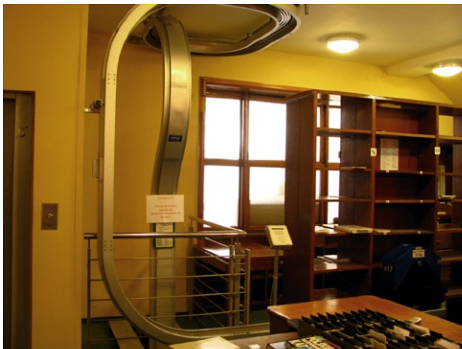
Tele-lift - system transportu książek w Bibliotece Jagiellońskiej
